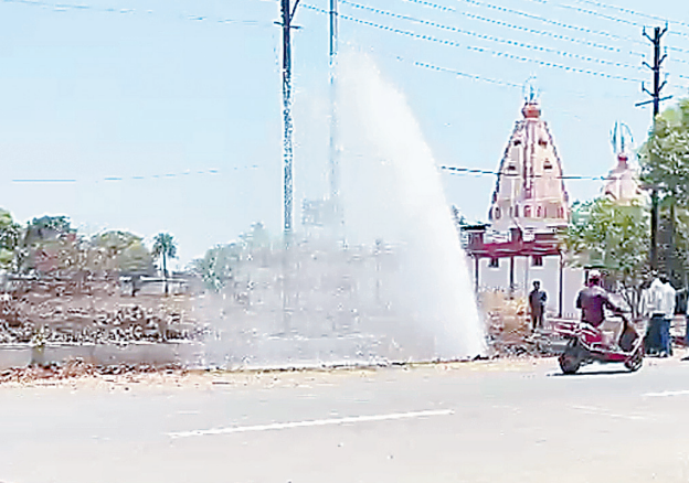
खुदाई के दौरान हुई पाइपलाइन क्षतिग्रस्त- स्थानीय लोगों के अनुसार बड़नगर रोड पर सड़क निर्माण और चौड़ीकरण का कार्य चल रहा है। इसी दौरान की गई खुदाई में ठेकेदार की लापरवाही के चलते मुख्य पेयजल पाइपलाइन क्षतिग्रस्त हो गई। यह पाइपलाइन अंबोदिया डैम से शहर में पेयजल आपूर्ति करने वाली प्रमुख लाइन बताई जा रही है।
