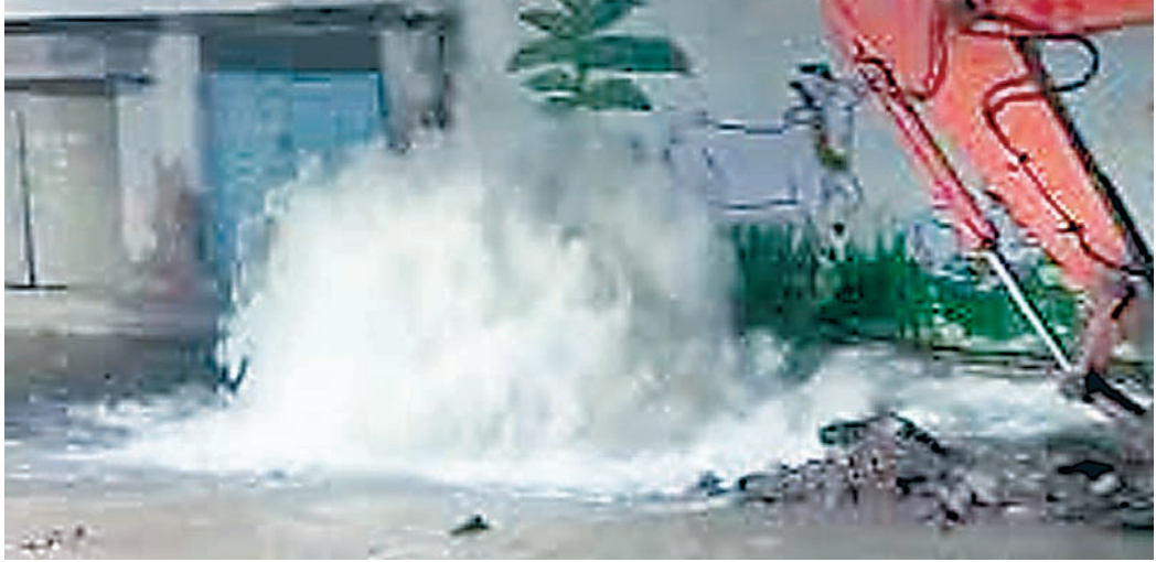
लिए करीब 11 अरब रुपए की पाइपलाइन बिछाने का काम चल रहा है। इसी दौरान लापरवाही के कारण गंभीर की मेन राइजिंग लाइन क्षतिग्रस्त हो गई। पाइपलाइन फूटने से
